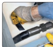
... den gerissenen Schlauch unter Spannung umwickeln
